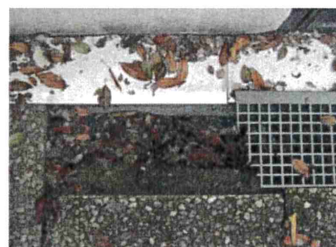
égout à nettoyer
