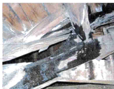
infiltration en toiture
