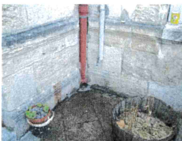
robinet et gouttière à réparer
