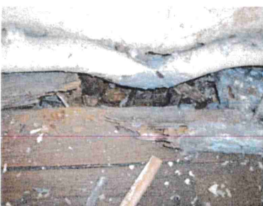
fuite de canalisation
